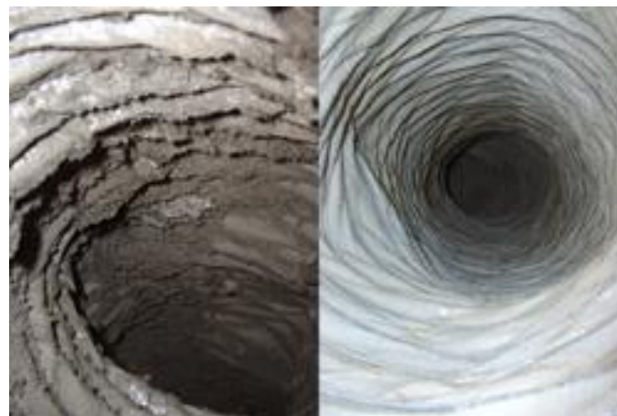
Hygiénisation des réseaux
